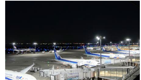
航空灯火・空港エプロン照明灯
